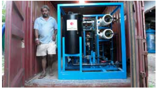
日本から支援された造水機
